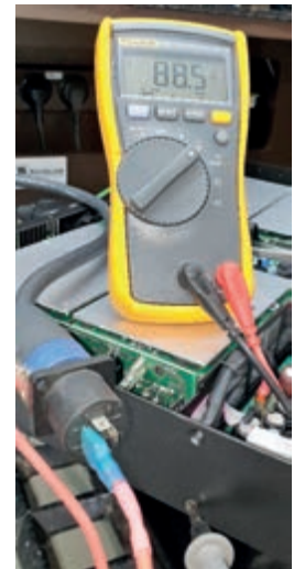
Bild 3: Allerdings führen sowohl Pin 1+ als auch Pin 1- vom Lautsprecher konstruktionsbedingt 88 Volt gegen Gehäuse beziehungsweise Schutzleiter – hier heißt es aufpassen
